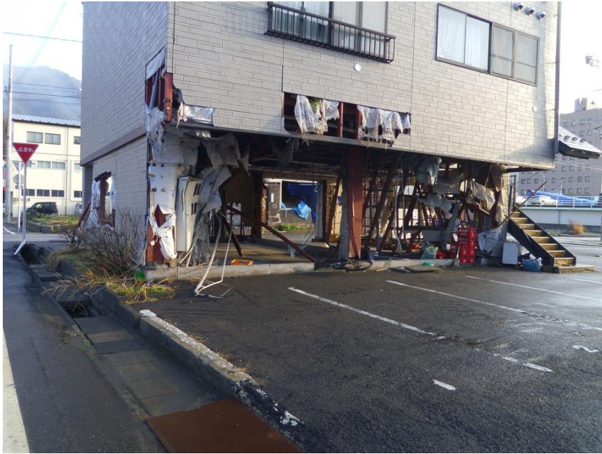
津波で1階部分の被害に
