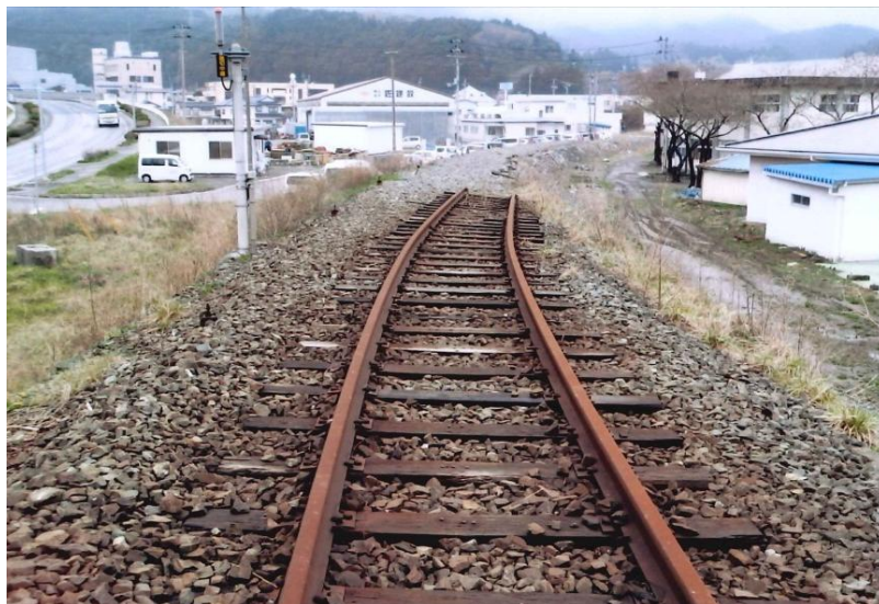
寸断された線路（三陸鉄道・盛駅付近）
