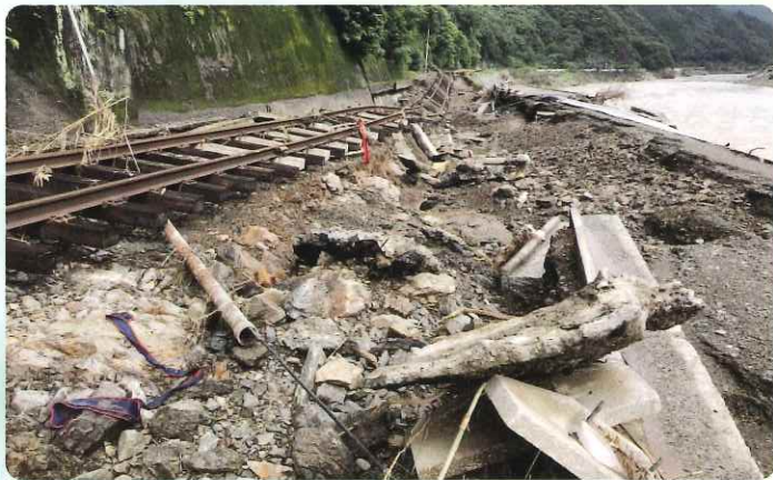
被災したJR肥薩線（葉木～鎌瀬間）
